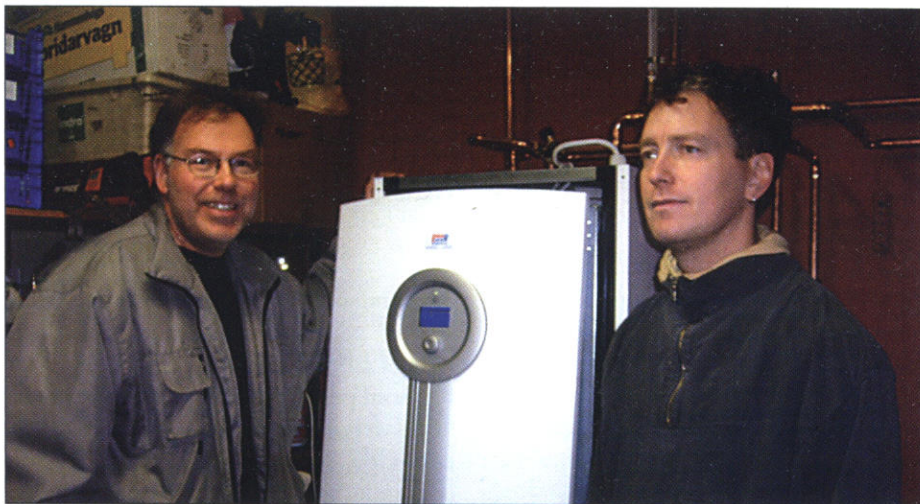
Peter Ahnelöv, t.v. har just installerat det senaste exemplaret av luftpumpar hos Peter Lindgren i Gröstorp.
